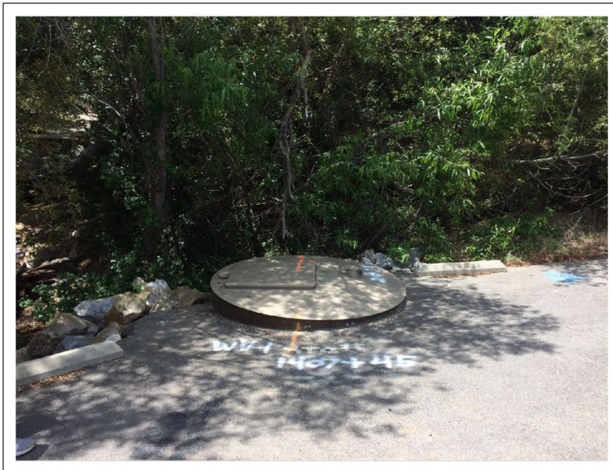
WWF1 STA 1407+45 existing blowoff.
